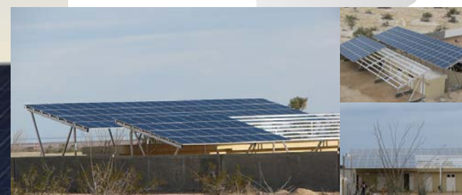
Emplacement : Mexique Taille du système : 28.8kW Type de construction : Abri de parking Fin des travaux : 2012 Installateur : Voltaika
